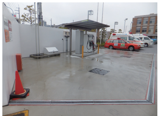
災害時における緊急車両等の燃料を確保するため、本市消防本部敷地内に設置された自家給油取扱所 (平成25年3月18日運用開始)
